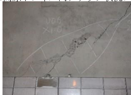
＜高原トンネル内クラック状況＞
